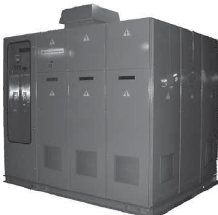
Quadro di rifasamento fisso con reattanze detuned, tipo PFI-FMR.
