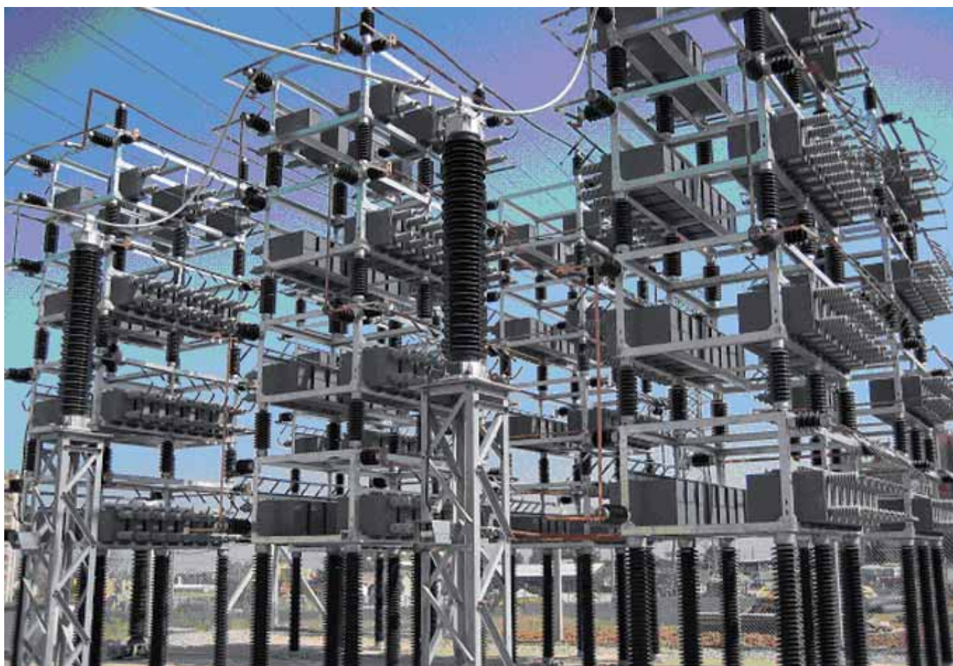
82.2 MVar - 170 kV - 50 Hz
